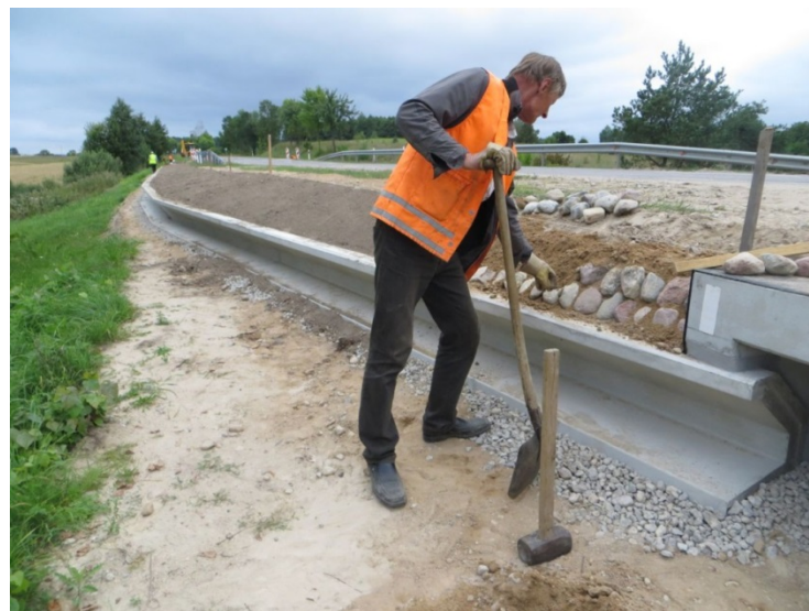
Gelžbetoninė varliagyvių praėjimo sistema. (fpp-consulting.lt nuotr.)
